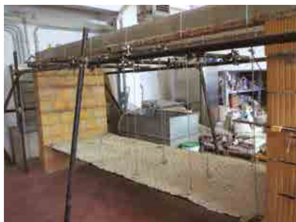
Prova di carico del sistema X-PLASTER appeso con un sistema di pendini al solaio esistente.
